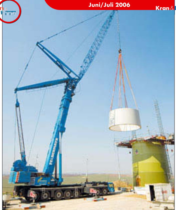
Der Liebherr LG 1750 wurde im April an Felbermayr ausgeliefert und kam gleich zum Einsatz beim Aufbau einer Windkraftanlage.
