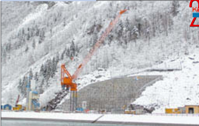
Auf der Baustelle beim mit rund 100 Millionen Franken aktuell größten Bauvorhaben im Glarnerland in der Südostschweiz setzt die Firma Kaufmann Kranservice den Wippkran Peiner SN 500 ein. Er wurde 2005 aus Deutschland importiert, generalüberholt, frisch lackiert und mit neuer Elektronik ausgestattet. Der Kran verfügt über eine Ausladung von 45 Metern und eine maximale Tragkraft von 10,5 Tonnen.
