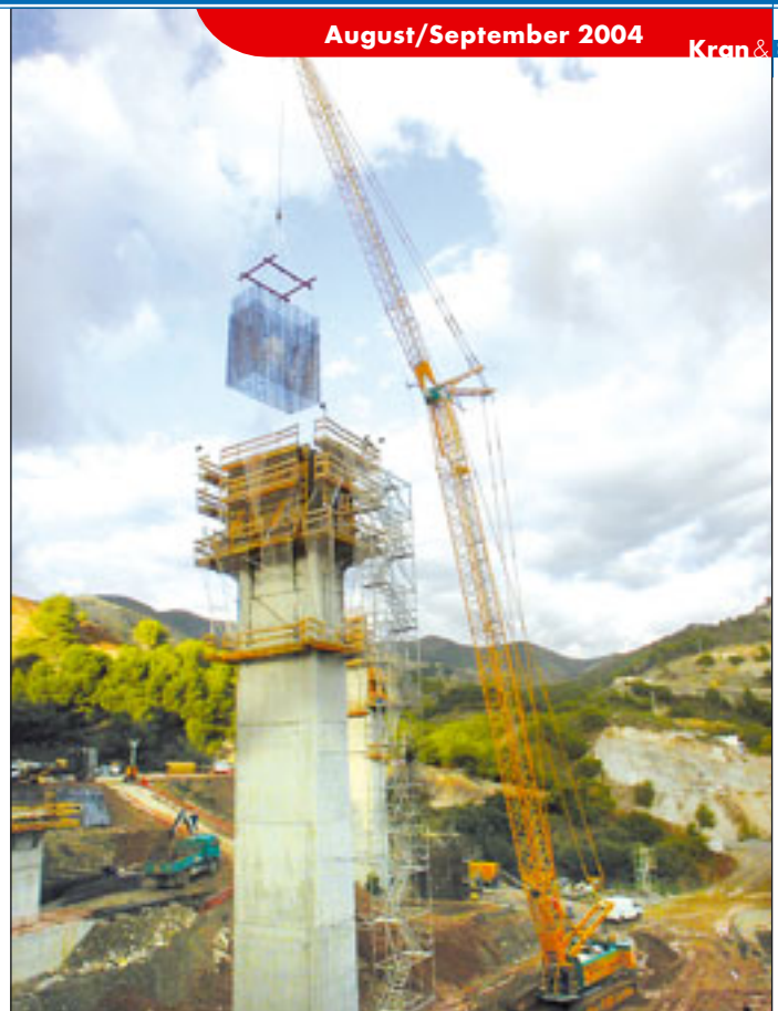
Das jüngste Mitglied aus der Reihe der Gittermastraupenkrane von Sennebogen, der Starlifter 3300 der Firma Guas Alhambra, beim Bau eines Brückenpfeilers in Spanien
