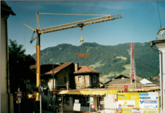
Um schnell und auf beengtem Raum arbeiten zu können, setzte das Bauunternehmen Spiluttini Bau einen Liebherr 32 TT ein. Gefragt war auch eine Tragkraft von einer Tonne bei 30 Metern Ausladung. Der Turm des Krans wurde extra auf 14,5 Meter Hakenhöhe eingefahren, um die Umschlagsleistung zu erhöhen.
