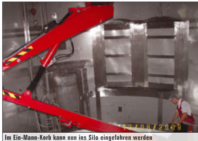
Im Ein-Mann-Korb kann nun ins Silo eingefahren werden
