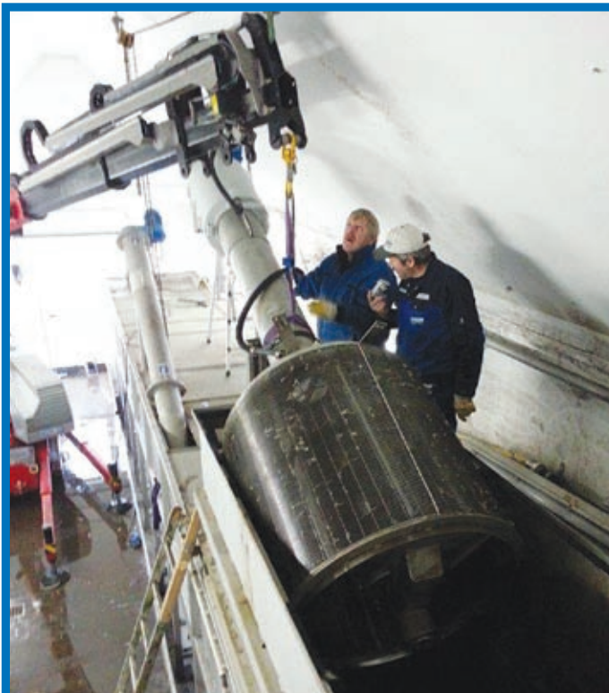
In Habichtswald muss die Kläranlage inklusive des 700 Kilogramm schweren Rechens regelmäßig gewartet werden. Die Eichenzeller Firma Wemo-Tec schickte dafür ihren Miniraupenkran SMK 190.4 in die Halle. Mit dem Knickpunkt des Kranarms bei vier Metern hat der Hub unterhalb der Hallendecke gerade so hingehauen.
