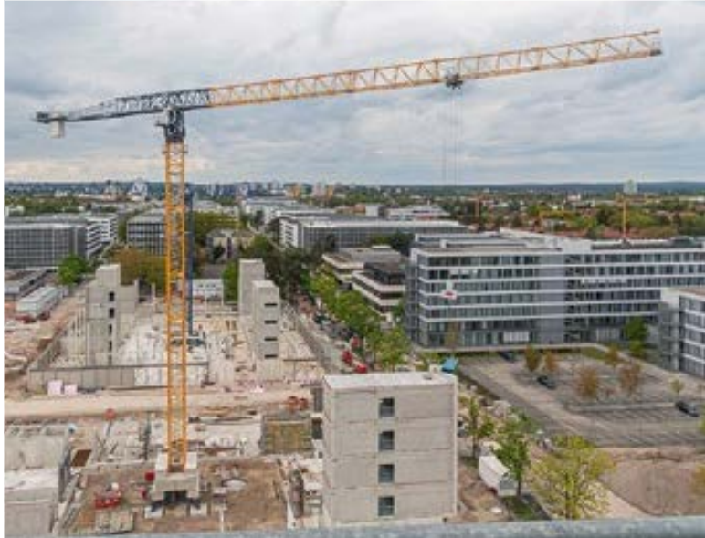
BKL montiert drei Krane am Siemens Campus in München, zwei Sáez TLS 80 20T und einen Comansa 21 LC 750
